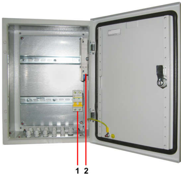
Рис.16 Уличная станция OS-341, внутренние элементы
